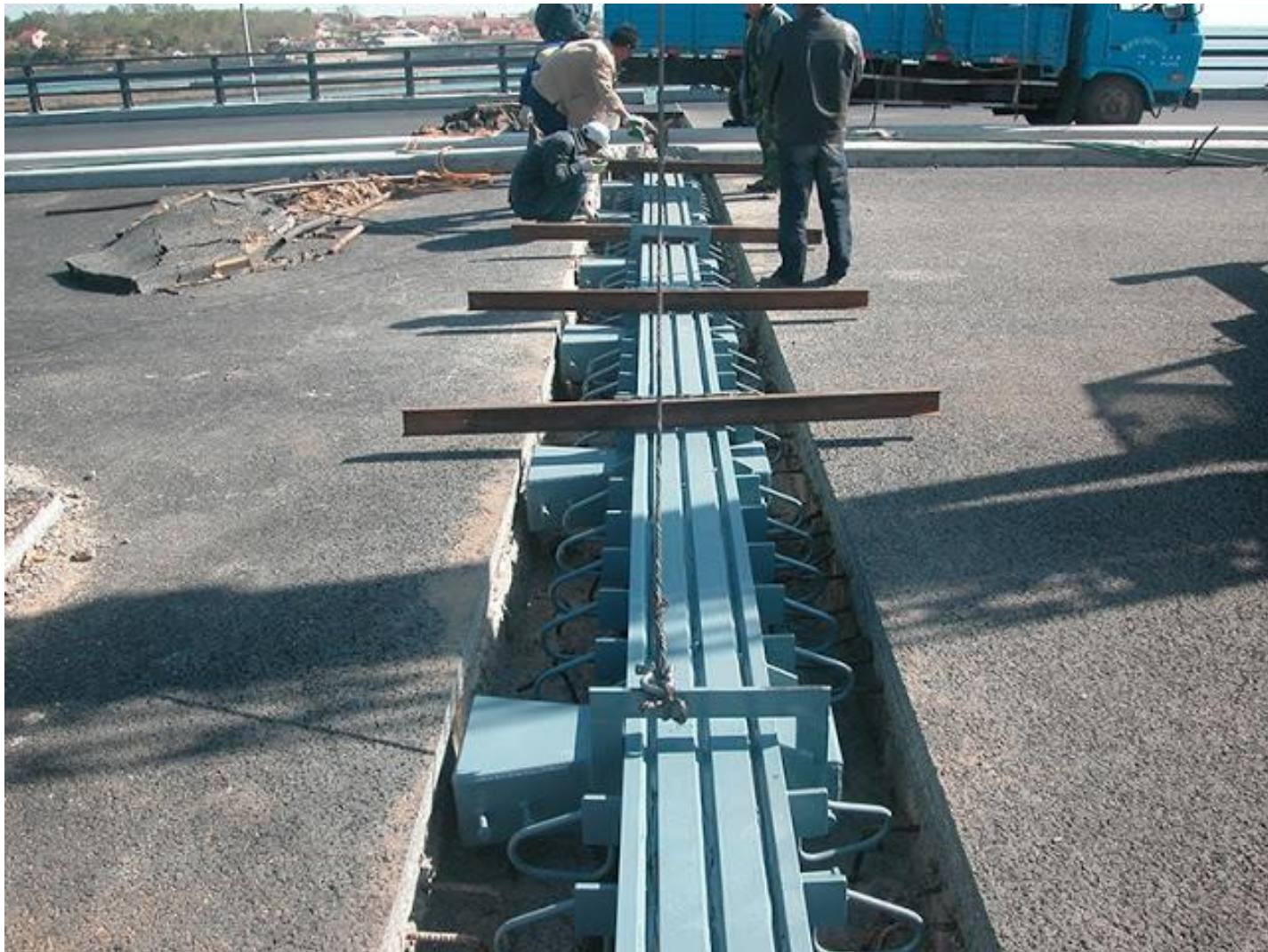
Junta de dilatación o expansión en un puente. Evita que al dilatarse los materiales, el puente se deforme debido a las enormes tensiones.
